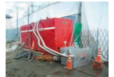
黒煙浄化装置
