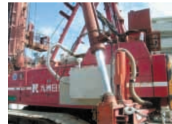
黒煙浄化装置
